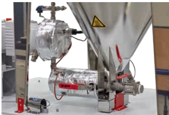
Elektrische Begleitheizung an Flüssigkeitsdosierer
